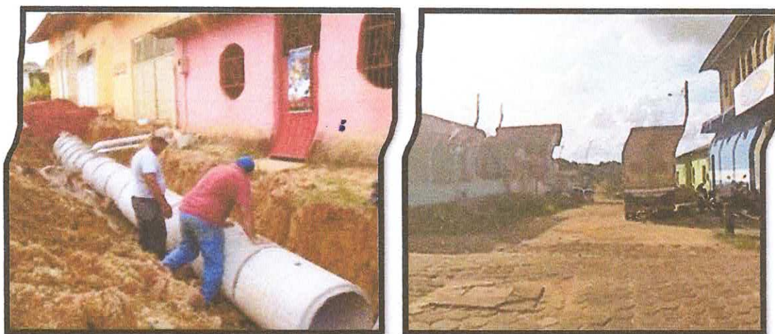
Figura x e x: Construção da galeria e poço de visita Fonte: Comitê Executivo
