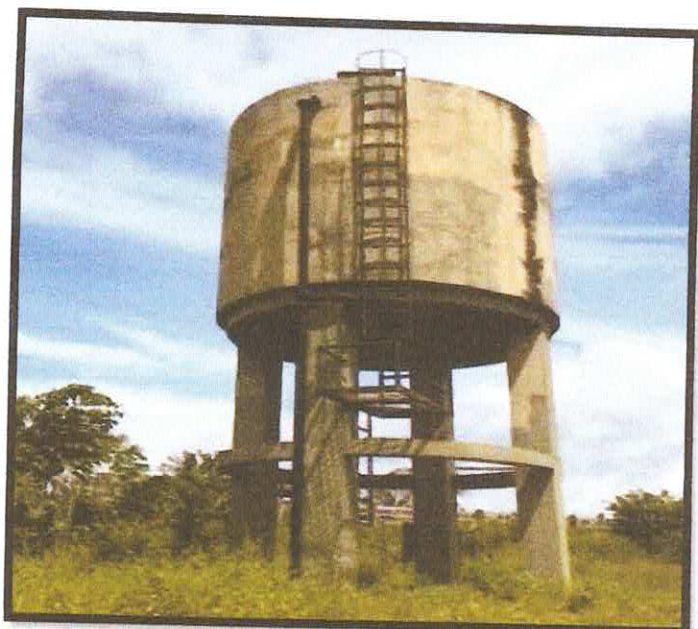
Figura 25: Sistema de abastecimento de água- Vila Surubim Fonte: Comitê Executivo
