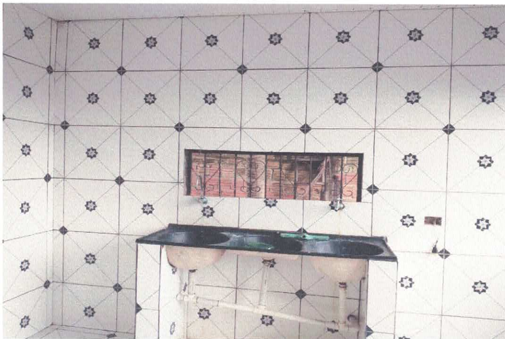
Imagem 11 – Área de serviço
